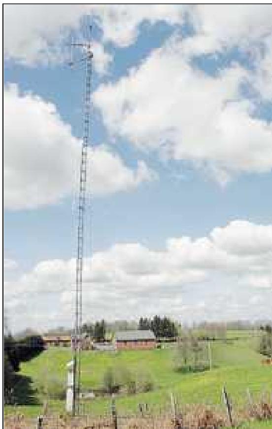
■ Une antenne relais dans le Limousin. Le haut débit constitue une vraie révolution pour les 710.000 habitants de la région.
